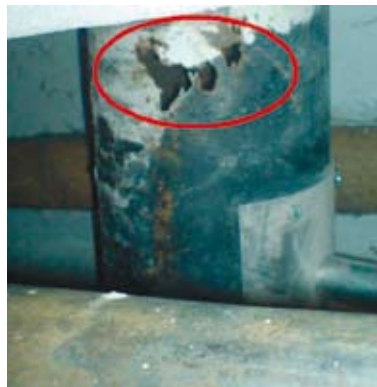
Et røgrør, der er tæret igennem, og har flere større huller.
