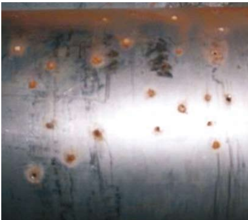
Punkttering af røgrør monteret på kornfyringsanlæg. Ofte bliver aftrækssystemet stærkt beskadiget allerede efter få måneders drift.
