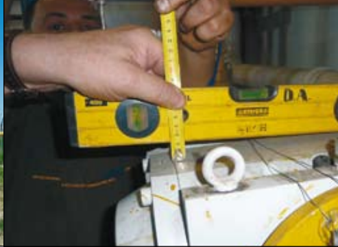
Skævt monteret gasmåler
